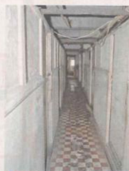
同樓其他單位亦被間成「割房」出租，環境惡劣。
